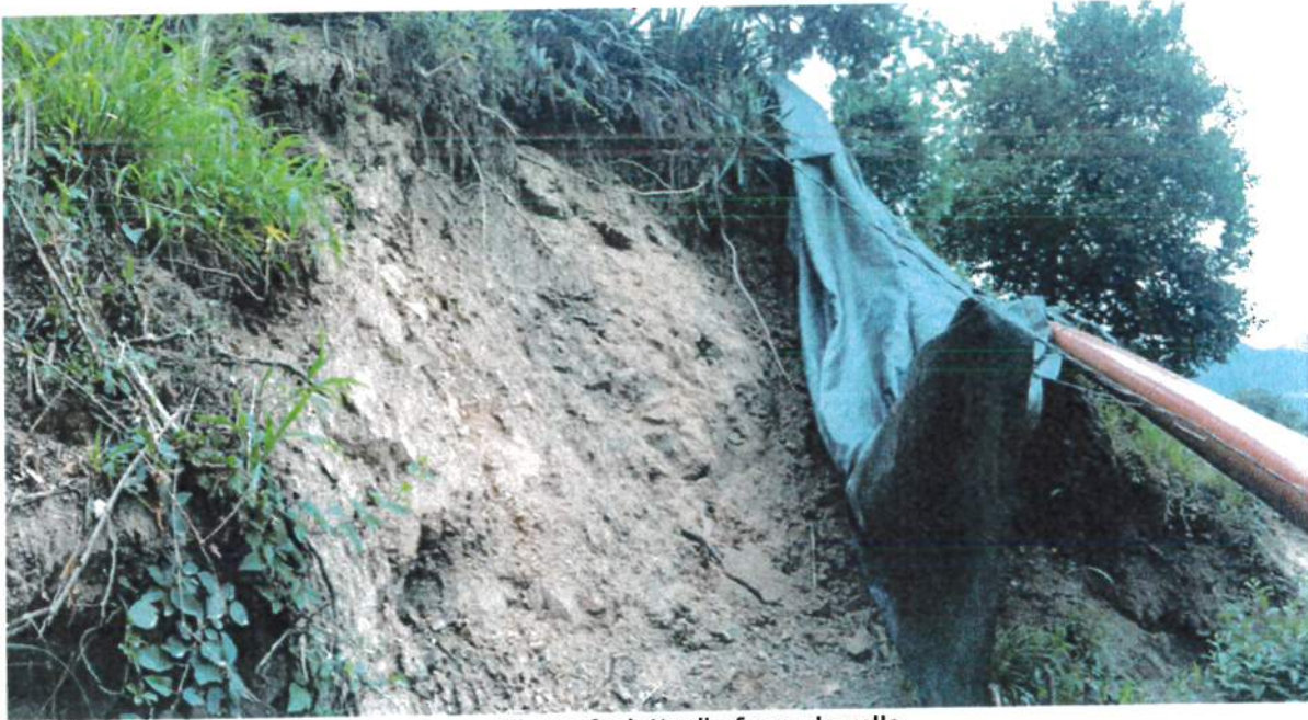
Figura 2: dettaglio frana da valle
