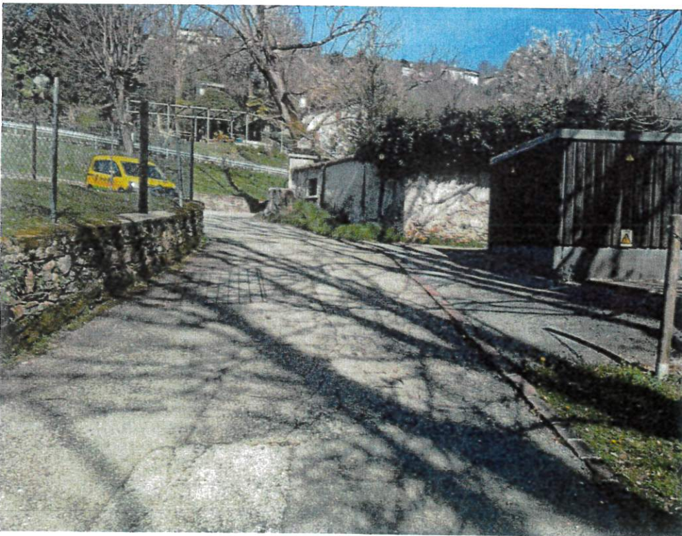
Figura 5: Via Robbiolo - stato pavimentazione
